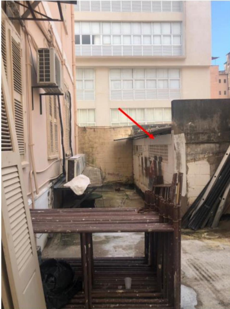
Foto 01 – Local onde está localizado a subestação do Prédio Sede e Anexo I e gerador da Diretoria de Informática.
