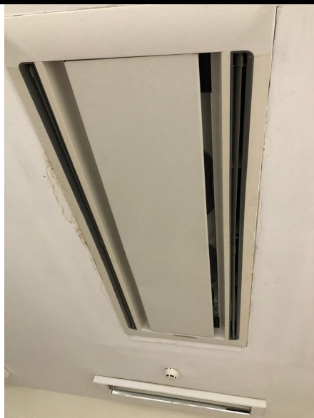
FOTO 10: EVAPORADORA LOCALIZADA NO SUBSOLO.
