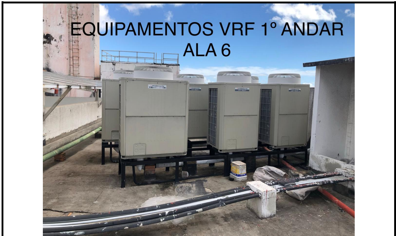
FOTO 03: CONDENSADORAS QUE SÃO INTERLIGADAS ÀS EVAPORADORAS DO PRIMEIRO PAVIMENTO DA ALA 06.
