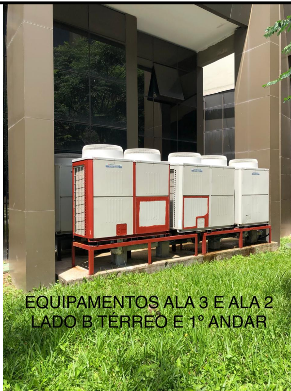
FOTO 08: CONDENSADORAS QUE CLIMATIZAM SETORES DAS ALAS 02 E 03.
