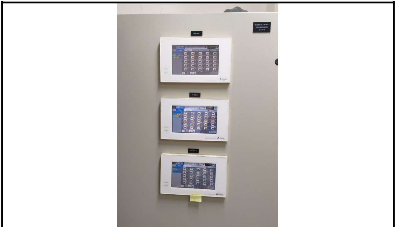
FOTO 11: PAINEL COM IHM's PARA OPERAÇÃO E VERIFICAÇÃO DE FALHAS.
