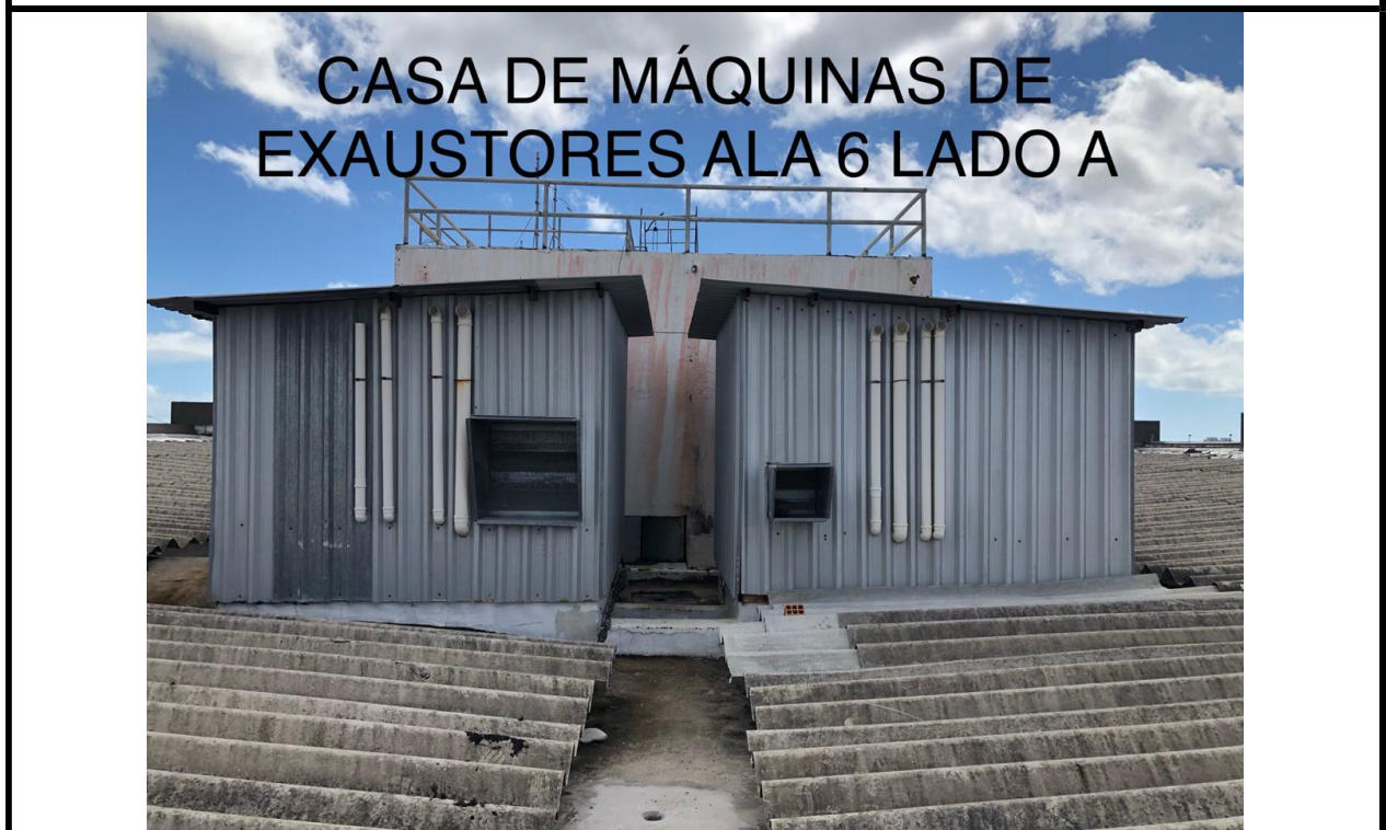
FOTO 04: CASA DE MÁQUINAS DOS EXAUSTORES DA ALA 06.
