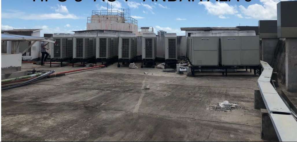
FOTO 01: CONDENSADORAS INTERLIGADAS ÀS VARAS LOCALIZADAS DO 3° AO 7° PAVIMENTO DA ALA 06, QUE POSSUEM AS MESMAS PLANTAS BAIXAS.
