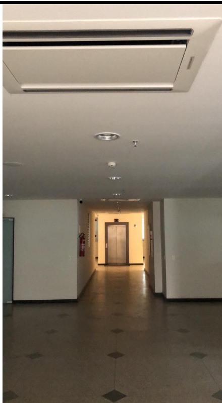
FOTO 09: EVAPORADORA DE UM CORREDOR DE CIRCULAÇÃO INTERNA DAS VARAS.
