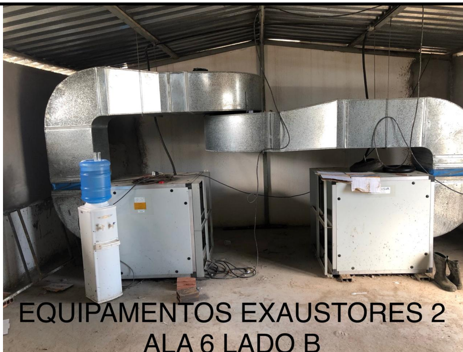
FOTO 05: INTERIOR DA CASA DE MÁQUINAS DOS EXAUSTORES.
