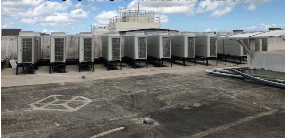
FOTO 02: CONDENSADORAS INTERLIGADAS ÀS VARAS LOCALIZADAS DO 3° AO 7° PAVIMENTO DA ALA 04, QUE POSSUEM AS MESMAS PLANTAS BAIXAS.
