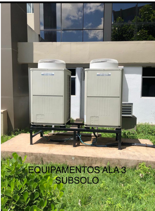
FOTO 07: CONDENSADORAS RESPONSÁVEIS PELA CLIMATIZAÇÃO DO SUBSOLO DA ALA 03.
