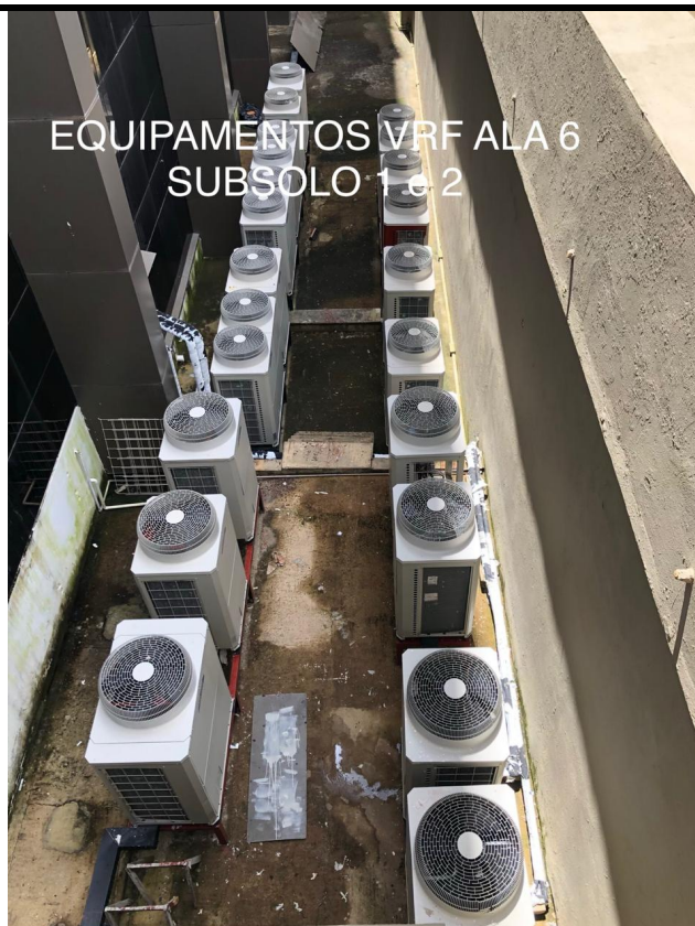
FOTO 06: CONDENSADORAS QUE ALIMENTAM EVAPORADORAS DOS SUBSOLOS DA ALA 06.
