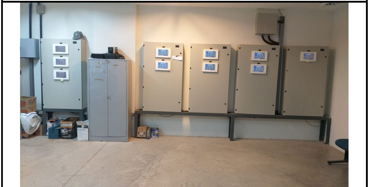
FOTO 12: PAINÉIS DA SALA DE CONTROLE.
