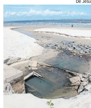
Areia cedeu e expôs esgoto
