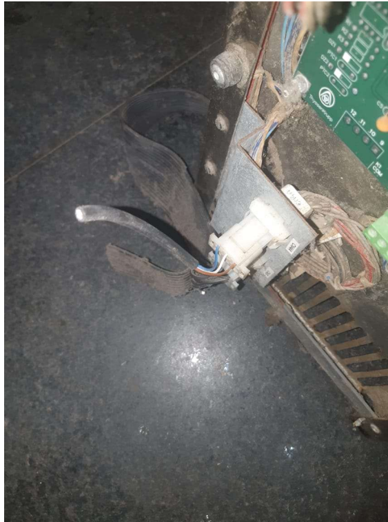
Figura 1 – Ausência de sensor magnético no Elevador 97014
