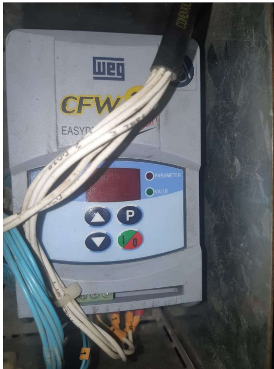
Figura 5 – Inversor CFW3 do Elevador 97014
