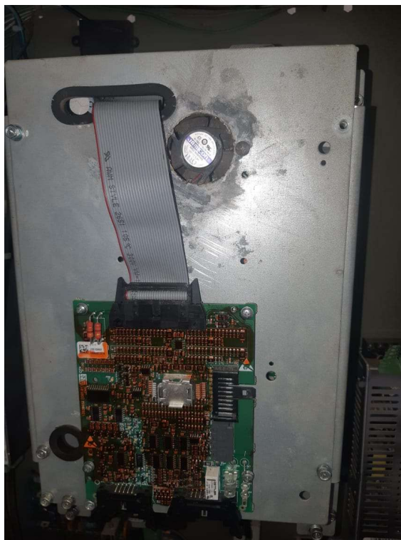
Figura 6 – Unidade de potência IGBT do Elevador 97014
