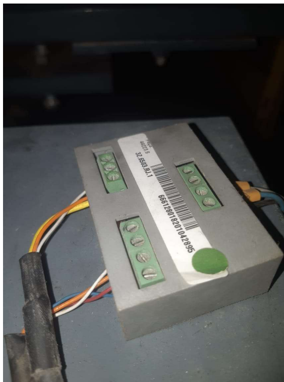
Figura 4 – Fonte do sensor de presença da porta do Elevador 97014
