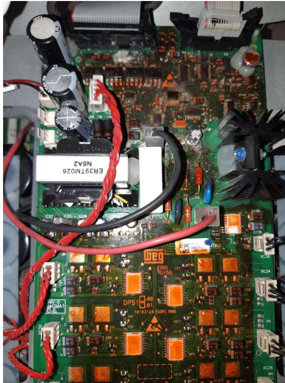
Figura 7 – Unidade de potência IGBT do Elevador 97014
