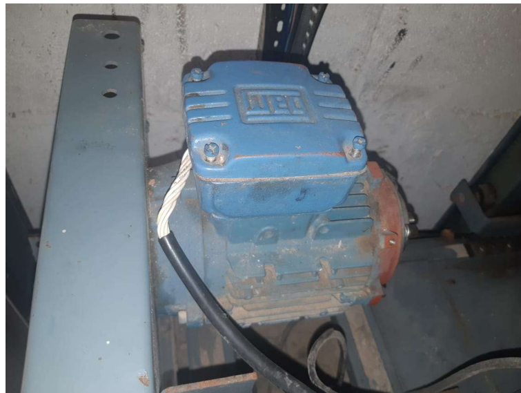
Figura 12 – Motor operador de porta do Elevador 97014
