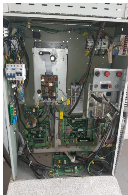
Fotografia 4: Quadro de comando
