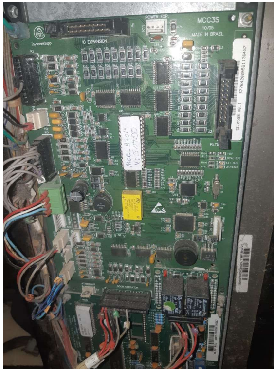
Figura 9 – Módulo MCC3 do Elevador 97014
