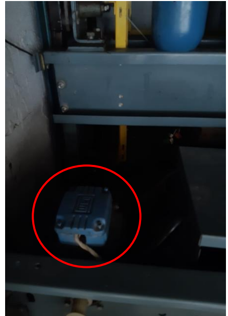
Fotografia 7: Motor operador porta
