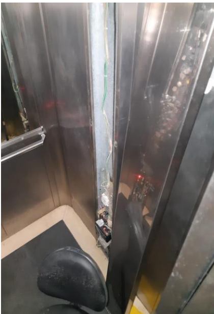
Fotografia 8: Painel de cabina
